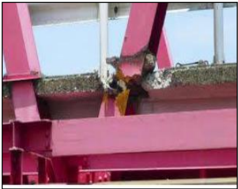
木曽川大橋破断写真
