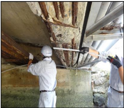
笹子トンネルの天井崩落事故
