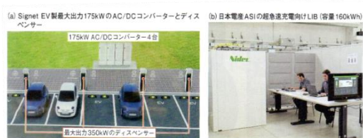
図5 超急速充電ではインフラに工夫が不可欠 350kW以上の超急速充電システムには、いくつかの工夫が必要になっている。その1つが、充電スタンドを、コネクタを挿入する「ディスプレイ」や「AC/DCコンバーター」など電源部に分離すること (a)。電流が小さくなって、従来の「充電スタンド」には納められなくなりつつあるのが電流の1つ。他の工夫では、電力系統と充電システムの間に大容量蓄電池をついで、送電出力の影響を電力系統に与えないようにする例が出てきた (b)。(写真：(a)は代理店の写真。(b)は日本電産)
