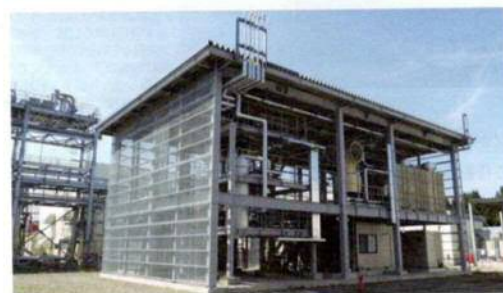
図18 メタネーション用プラントも試験稼働 NEDO、国際石油開発帝石、日立造船が開発し、新潟県長岡市に設置したメタネーションのプラント。天然ガス改質で出るCO 2 と水電解によるグリーン水素でCH 4 を合成する。2019年秋～2020年3月に試験運転した。（写真：国際石油開発帝石）
