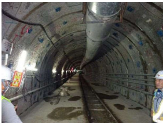
図6 避難坑における鋼鉄製の支保工（アーチ状）とロックボルト（青色の点）
